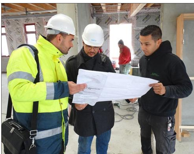
Mohammed Guendouz vient souvent rendre visite aux chefs de chantier et aux ouvriers pour s'assurer du bon déroulement des travaux.
